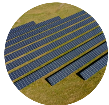
Photovoltaikanlage in Geseke
